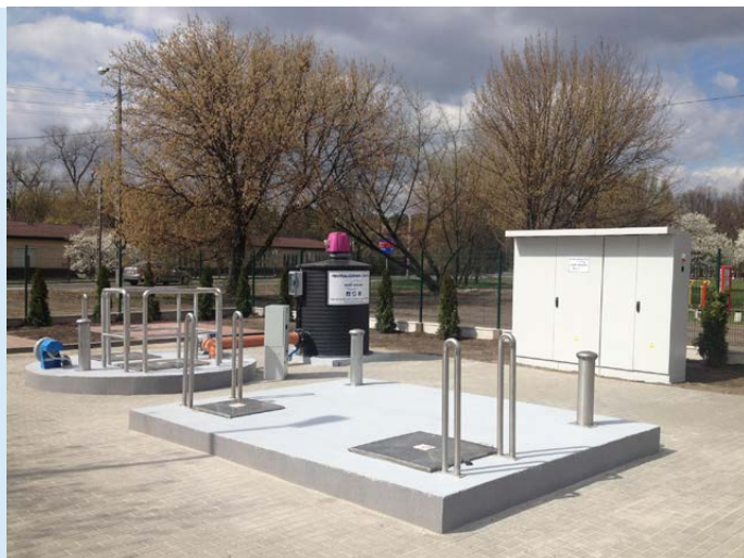
Neutralizator przy Pompowni Rembertów w Warszawie
