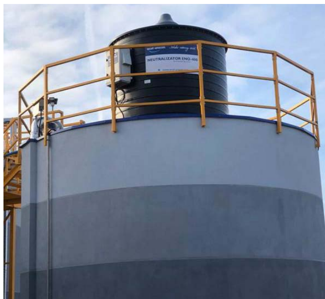
Neutralizator przy zakładzie WEKO Polska w Moszczance
