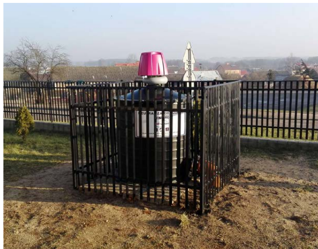
Neutralizator przy Pompowni w Wąsoczcu
